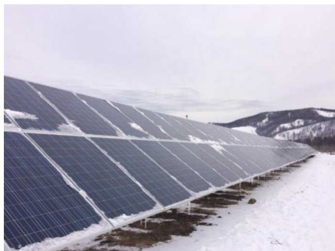
Рисунок 3.2 – Панели солнечной электростанции
